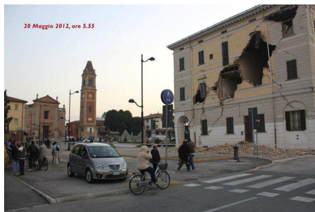
I danni subiti dalla sede municipale a seguito del sisma.
